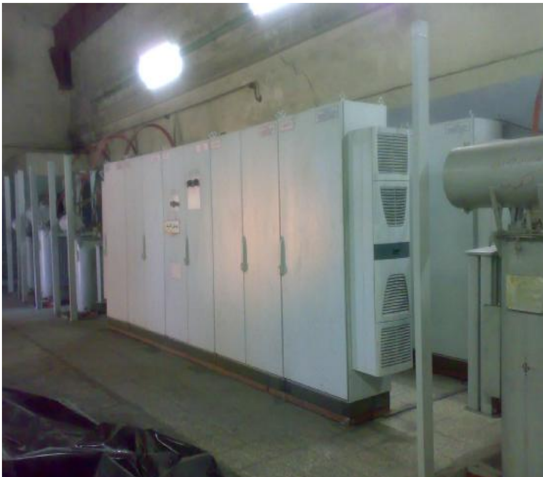
شکل شماره (4) - محل نصب سیستم درایوهای جدید DC پست برق 4RP ذوب آهن اصفهان
