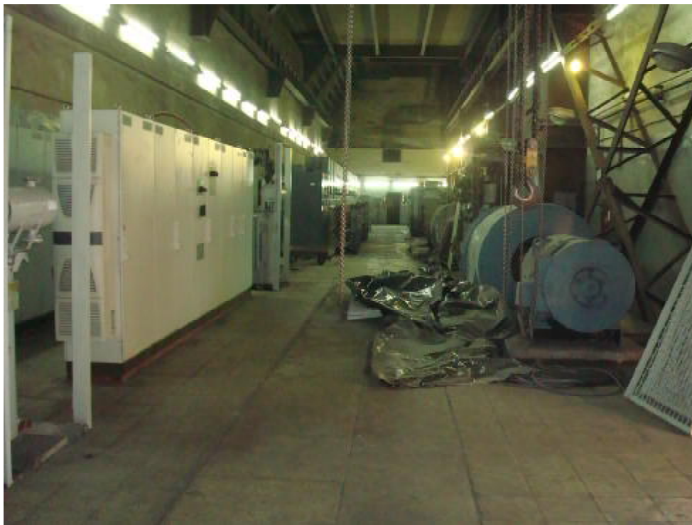
شکل شماره (5) - محل نصب سیستم موتور و ژنراتورهای قدیم و سیستم جدید درایوهای جدید در ذوب آهن اصفهان
