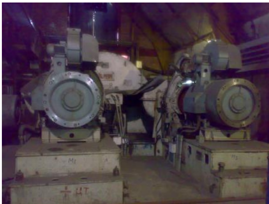
شکل شماره (7) - نمائی از محل نصب سیستم موتور زنگ کوره بلند شماره 1 ذوب آهن اصفهان
